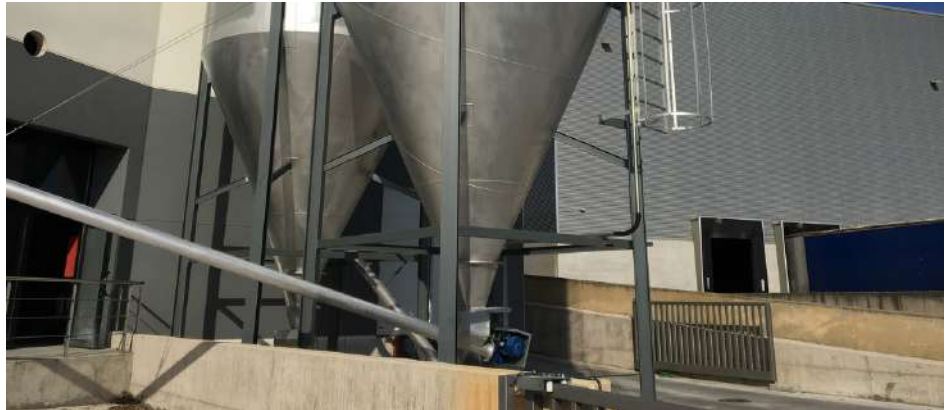
Silos a medida con filtro y sinfines
